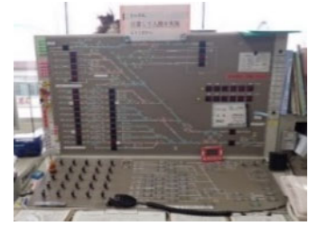
▲連動制御盤（連動装置）
